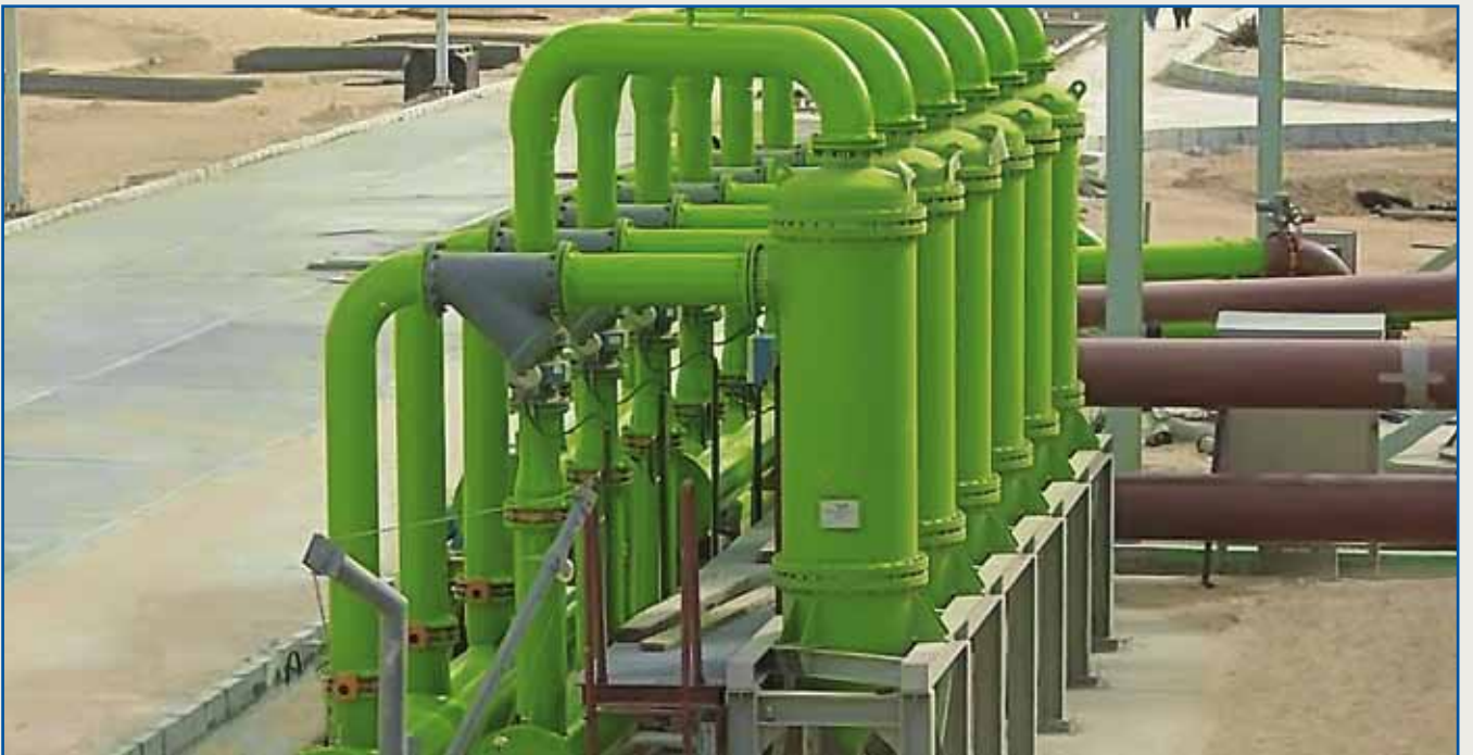
Abb. 7 Spritzwasser-Filtration im Walzwerk
